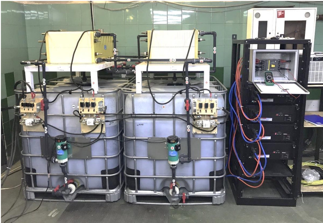
Действующая пилотная система (на фото) – 30 кВт / 50 кВтч
